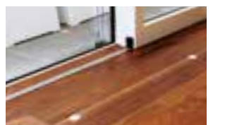
Laufschiene dezent im Fußboden eingelegt.
